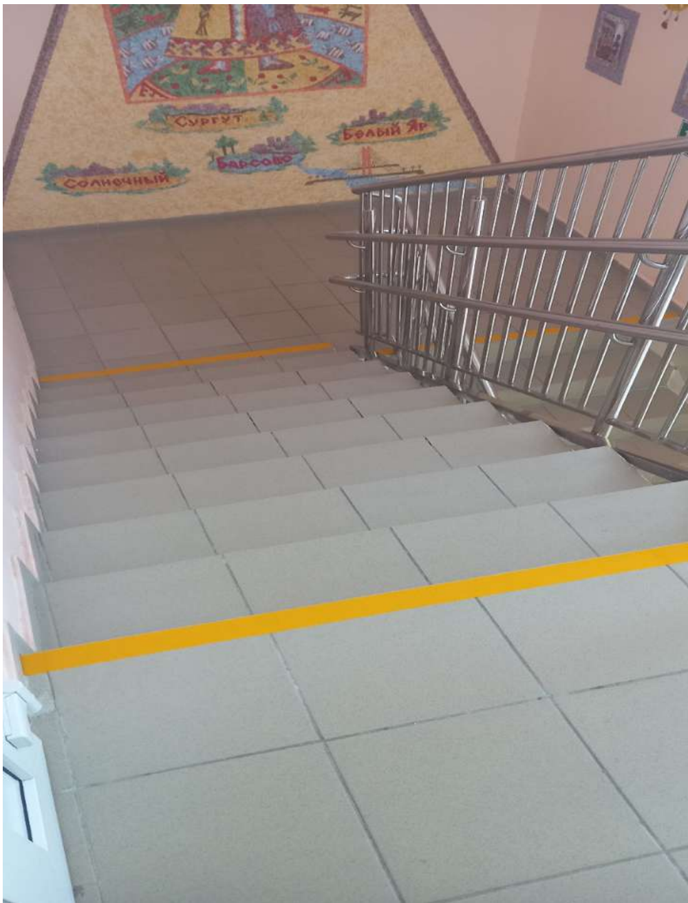
Фото 11. Лестница (внутри здания). Отсутствие пандуса внутри
